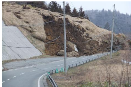
震災時に土砂崩れが発生し、封鎖された国道342号（地震直後）。
